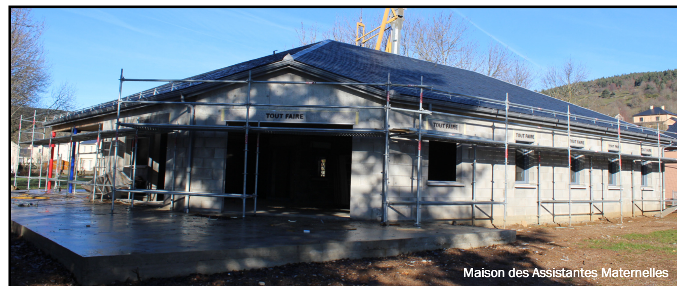
Casiers et garage
